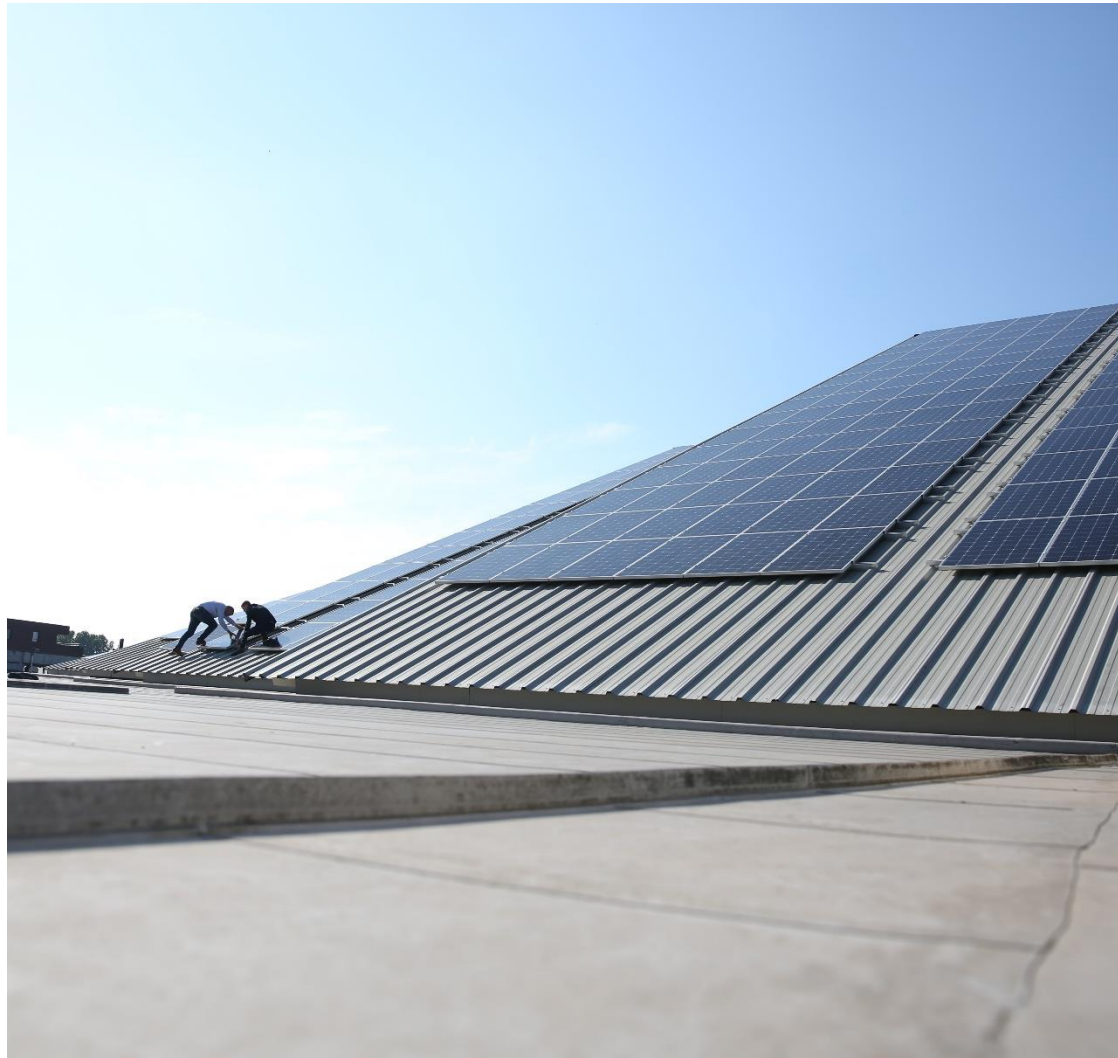
Solar panels at Vier Meren, Hoofddorp
